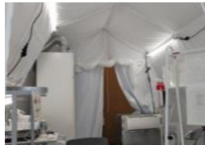
左図のテントを医療用陰圧テントとして使用している事例（テント内部） 「排気陰圧装置(左奥)」でテント内部空気圧を外部より低くし感染源拡散防止
