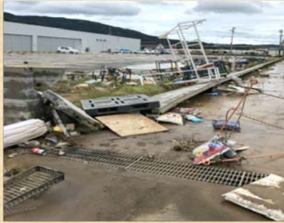
倒壊したブロック塀
