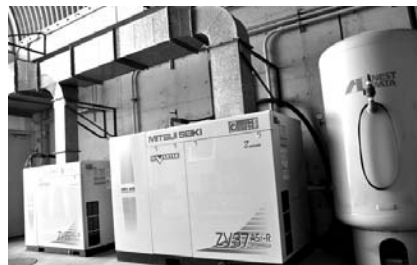
▲手前が 37kW のコンプレッサー。
