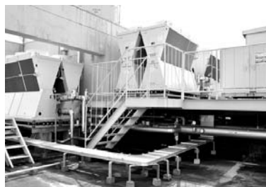
▲効率の良いヒートポンプチャラー。
