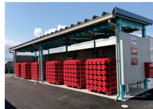
水素ガスカードル
